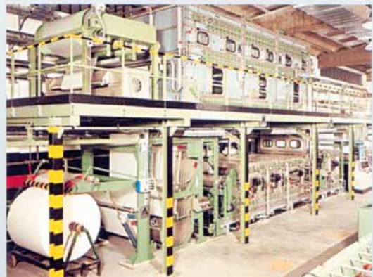
Babcock - Naßbehandlungsanlage mit MITEX Textilwalzenbeschichtungen
