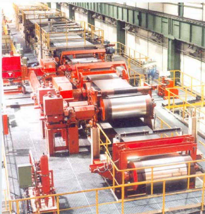
Salzgitter Flachstahl AG Bandbehandlungsanlage MITEX Gummi- und PUR-Walzenbeschichtungen
